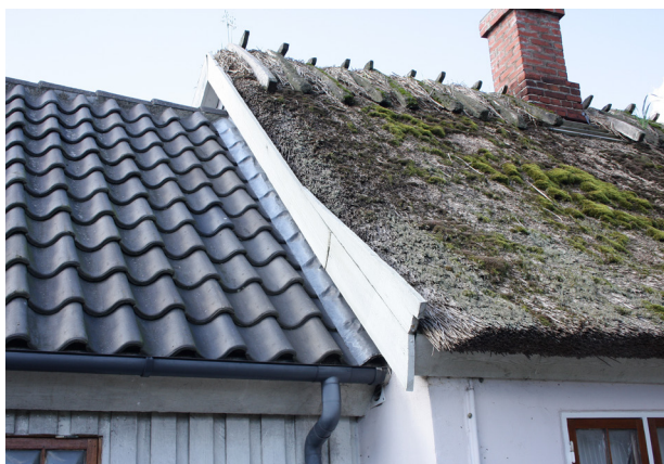
Tilbygningens tag fremstår med en markant anden profil end den oprindelige hovedbygning, hvilket bidrager til at boligen får et uharmonisk udtryk
